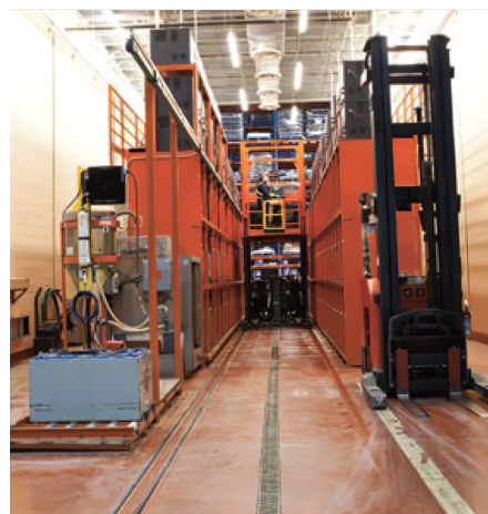
Zone de charge de batterie ventilée Photo : André Caty
