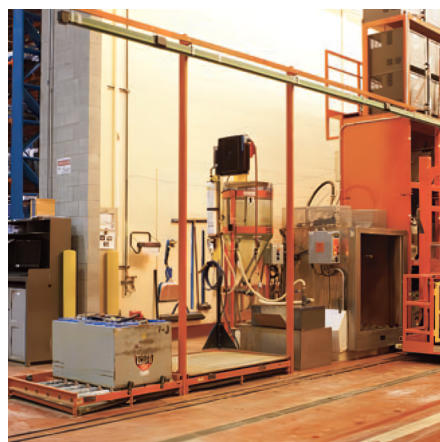
Chambre de batterie Photo : André Caty
