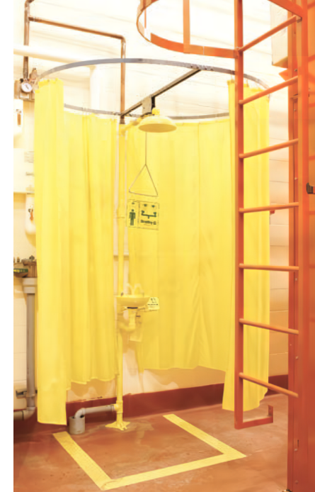
Douche de secours et douche oculaire Photo : André Caty
