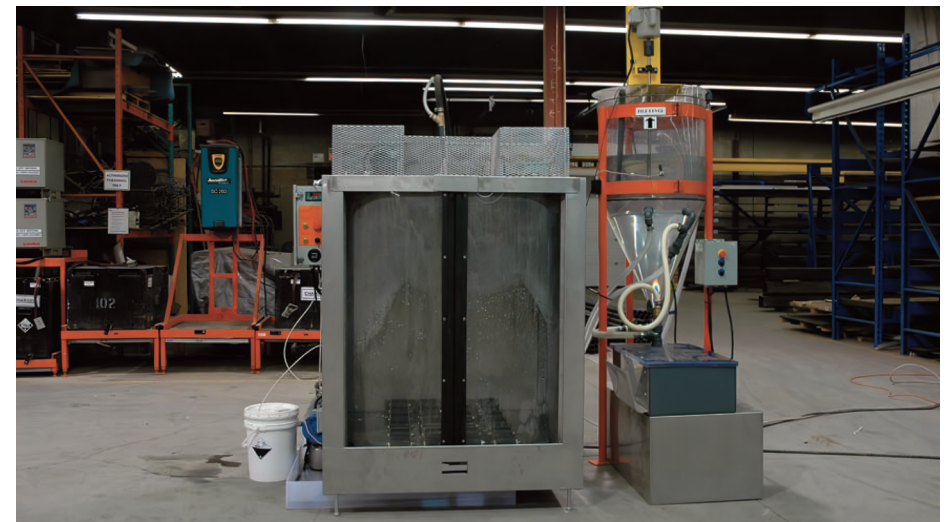
Station de lavage des batteries
